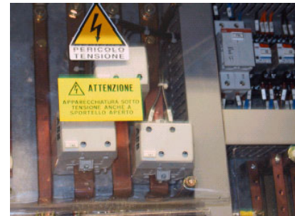
Il.5: transformator prądowy TAM zamontowany w zespole sprężarek
